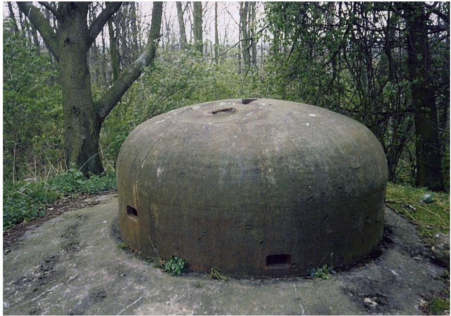
Figure 11: Coupole d'observation Eben 3 sur la casemate "Maestricht 2" avec impact d'une charge creuse
