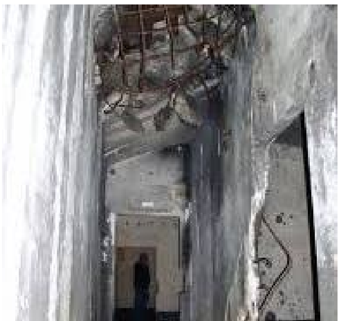
Figure 7: Fort d'Aubin-Neuchâteau. Voûte de galerie souterraine percée par obus Röchling
